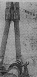
Снимок сделан в момент, когда заканчивался монтаж проводов высоковольтной линии электропередачи Запорожье — Николаев на Запорожском 300 киловольт. Скоро по этим проводам пойдет электрический ток.
