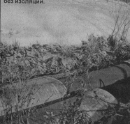
Трубы отопления без изоляции.
